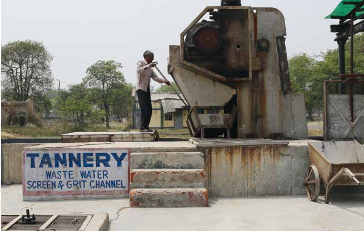
In einer öffentlichen Kläranlage in Kanpur werden Gerbereiabwässer aufbereitet
